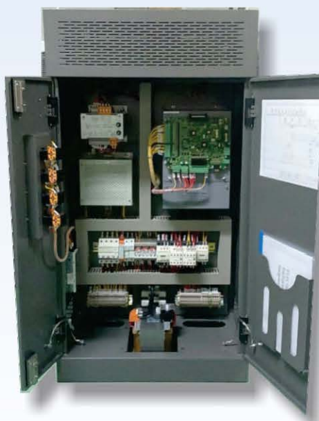
TỦ ĐIỆN FUJI - MALAYSIA
