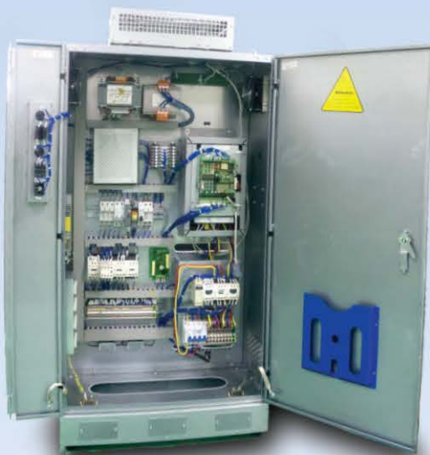
TỦ VI XỬ LÝ ĐỒNG BỘ TỦ ĐIỆN STEP - THAILAND
